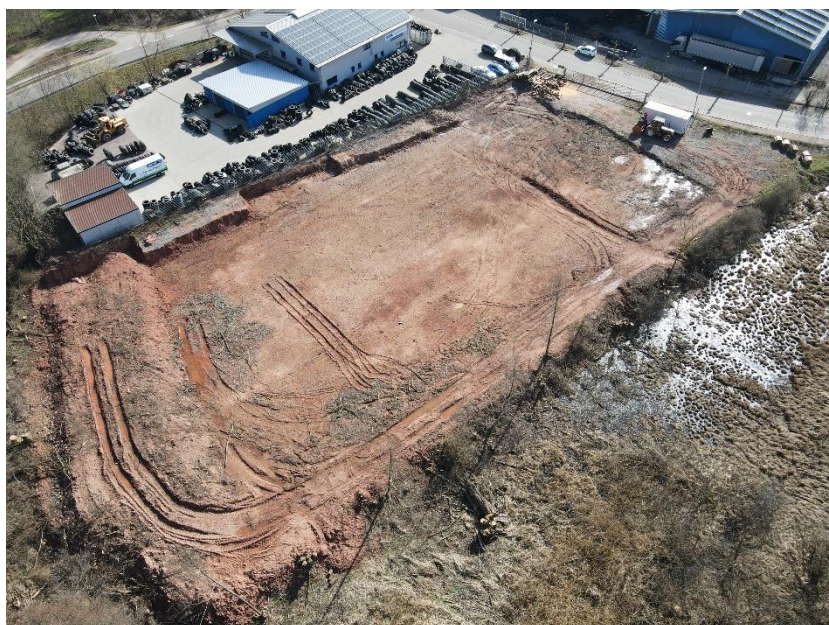
Abbildung 3: Das Baugelände des Forsthof Annweiler bei den Erdarbeiten (Foto: Trifels Natur GmbH)
