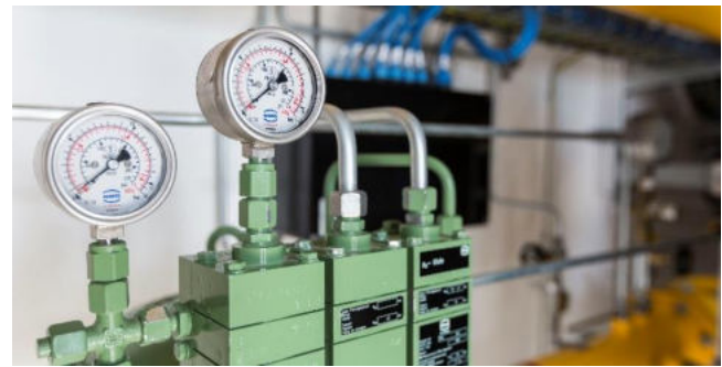
Foto / photo : Energieagentur Rheinland-Pfalz
