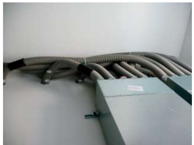
Blick auf die Technik (Foto: ARGE SOLAR)
