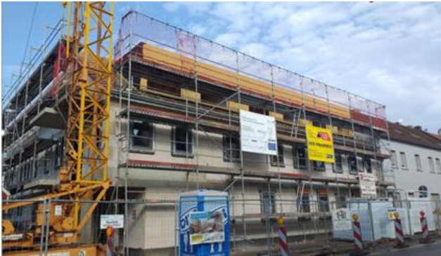
Pilotprojekt Herrenstraße 33-37 in Saarlouis-Roden Ende August 2019 /Projet pilote de la Herrenstraße 33-37 à Sarrelouis-Roden, fin août 2019 (Foto/photo: GBS)
