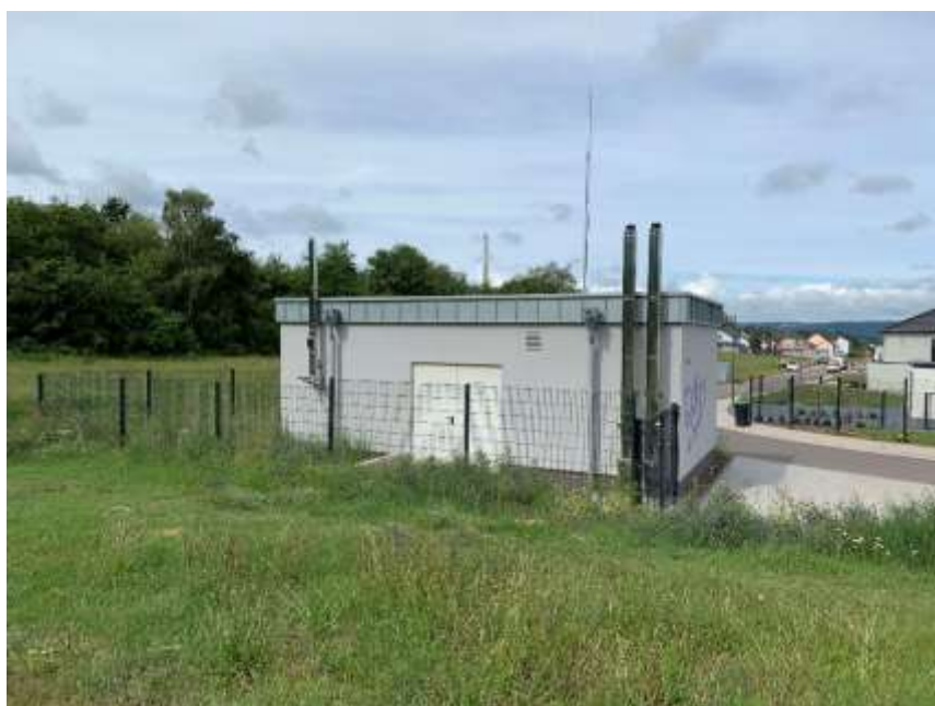
Vue arrière de la sous-station de chauffage local
