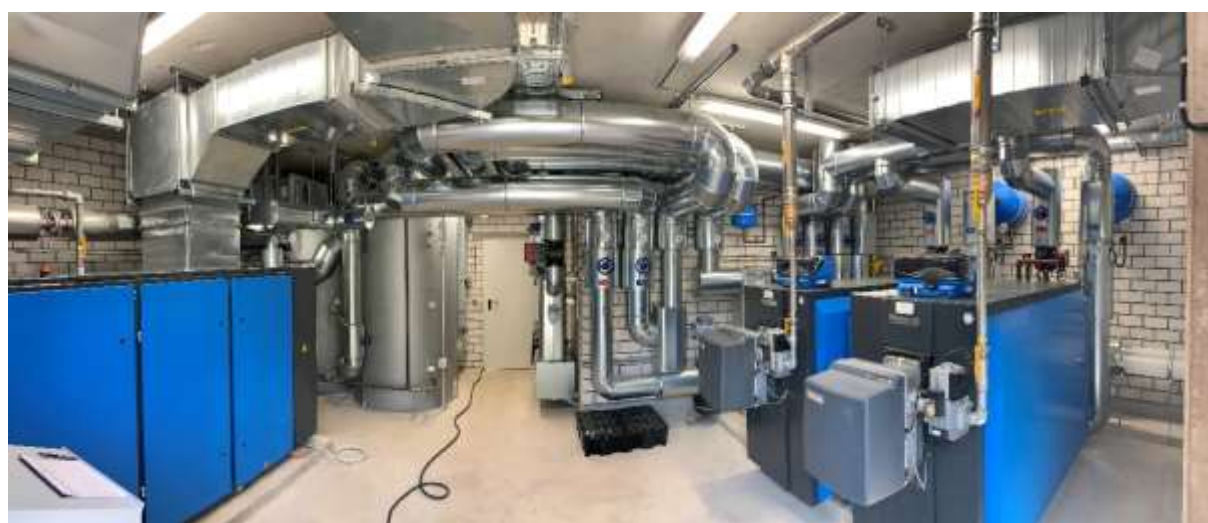
Vue intérieure en perspective de l'installation technique © GWBS
