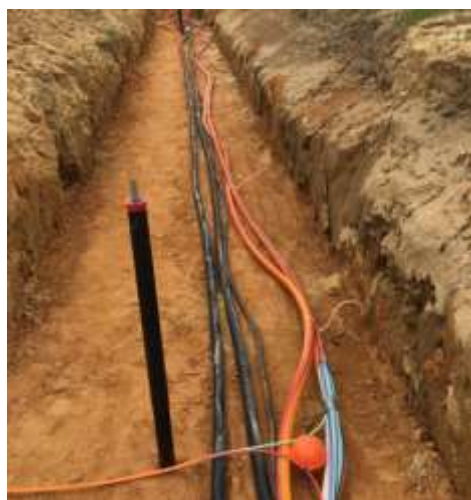
Niveau de pose supérieur avec câble de commande, télécommunication, alimentation électrique, éclairage © GWBS
