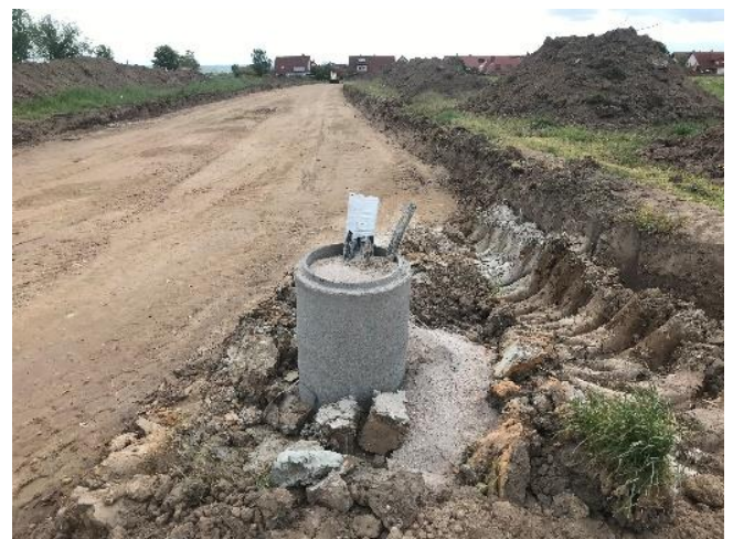
Forage pilote achevé – Celui-ci a lieu au début des travaux (Photo : Pfalzwerke)
