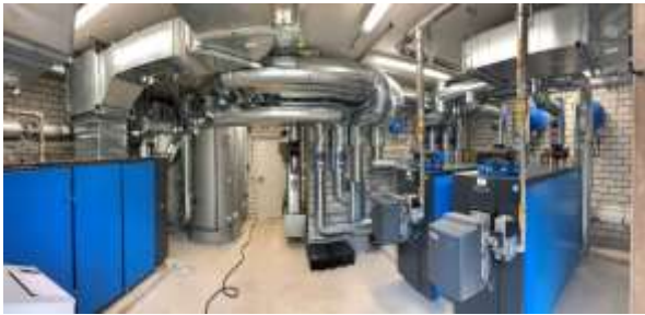
Nachhaltige Quartiersversorgung Ensdorf-Süd II, Saarland Schwerpunkt: smartes Quartier - Sektorenkopplung
