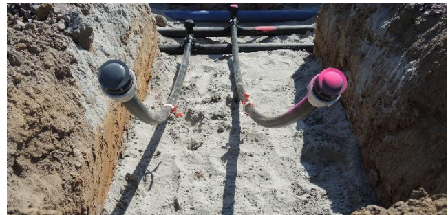
Foto / photo : Energieagentur Rheinland-Pfalz
